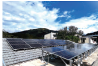
4.羅浮高中防災型太陽光電發電系統1座
